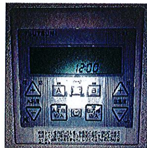
床暖房 2面切替 コントローラー
